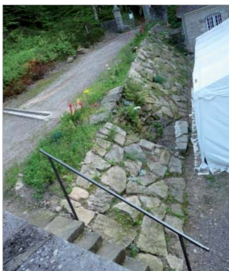
Mur de soutènement de l'accès au site, rénové en 2011 et financé par la Fondation Gilles et Monique Cugnier.
