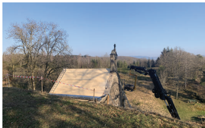
Un plancher constitué de lattes pour tenir les laves fixées avec des clous en acier inoxydable
